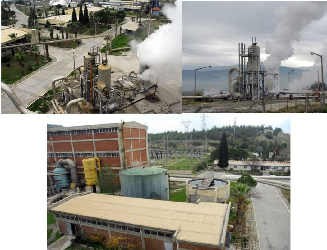
Şekil 22. Denizli Sarayköy Jeotermal Sahası (Zorlu Doğal Elektrik Üretimi A.Ş. 2011)
